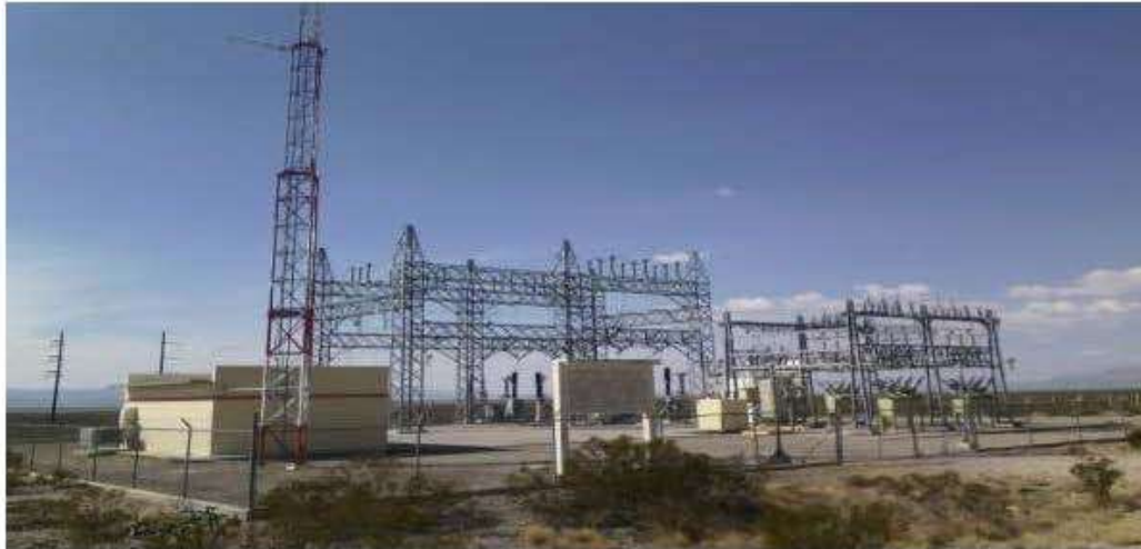
SUBESTACIÓN ELECTRICA SALINAS DEL REY
