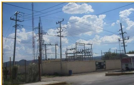
Subestación eléctrica con 6.5 mva. de capacidad en acceso de carretera a Cuatro Ciénegas.
